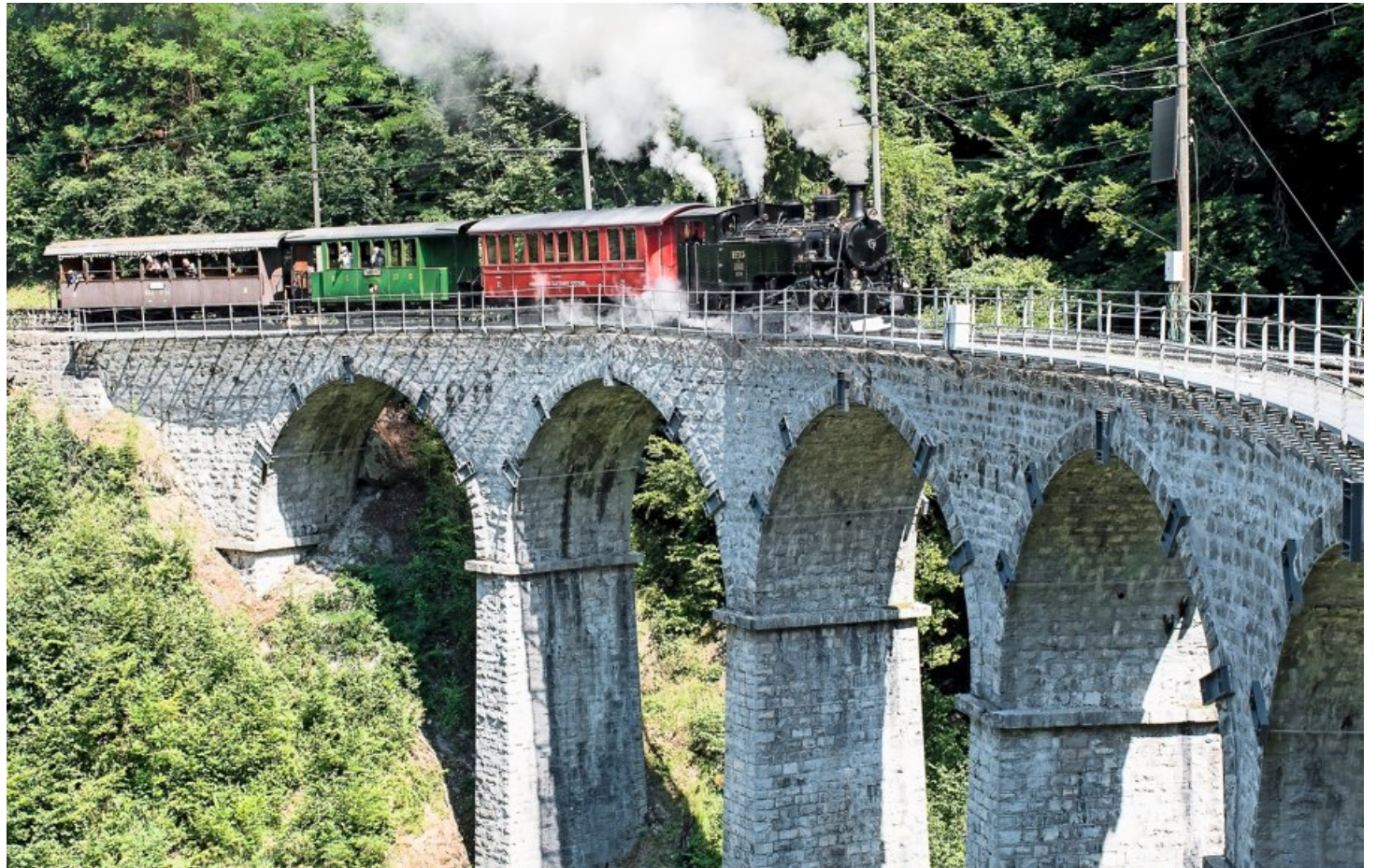
Affecté de déformations importantes, le vieux viaduc sur la torrentueuse Baye de Clarens pourrait s'effondrer. FLORIAN CELLA
