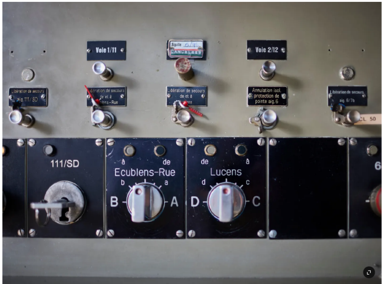
Nach den Bauarbeiten werden die Stellwerke von der Betriebszentrale in Renens bei Lausanne aus gesteuert. Foto: Yvain Genevay / Tamedia
